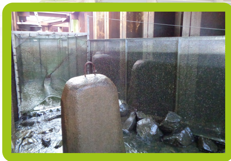
Bild 1: Fangeinrichtung mit Rechen und 10 mm Netzreue; Ansicht stromauf.
